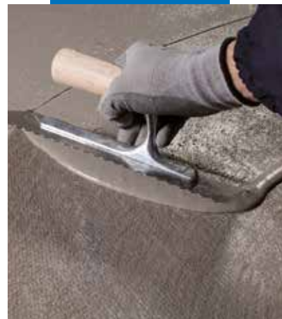
Aplikácia druhej vrstvy Mapelastic Turbo na prvú vrstvu, vystuženú sklotextilnou mriežkou odolnou proti alkálickým vplyvom
